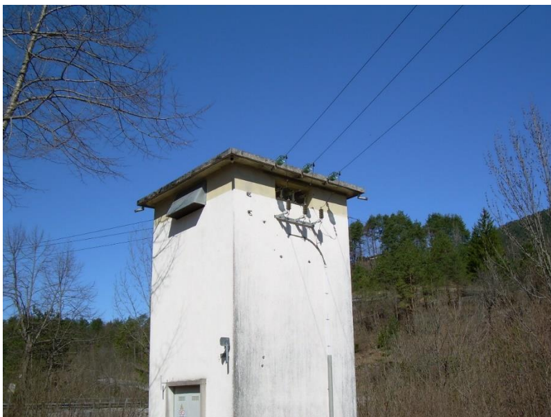
Figura 7.9: Cabina di trasformazione
