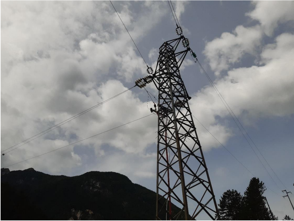
Figura 7.1: Traliccio dell'alta tensione
